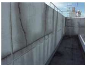
日光川河口排水機場 建屋のひび割れ
