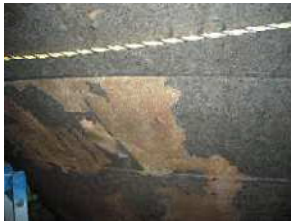
日光川河口排水機場 ケーシング上部の塗装剥離
