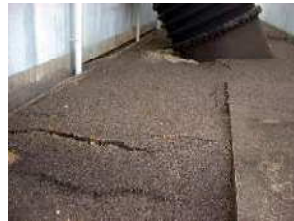
尾西排水機場 周辺地盤の沈下状況
